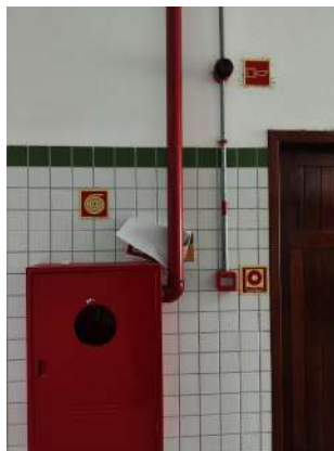
Foto 48: Extintores de incêndio
