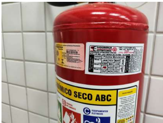
Foto 47: Extintores de incêndio
