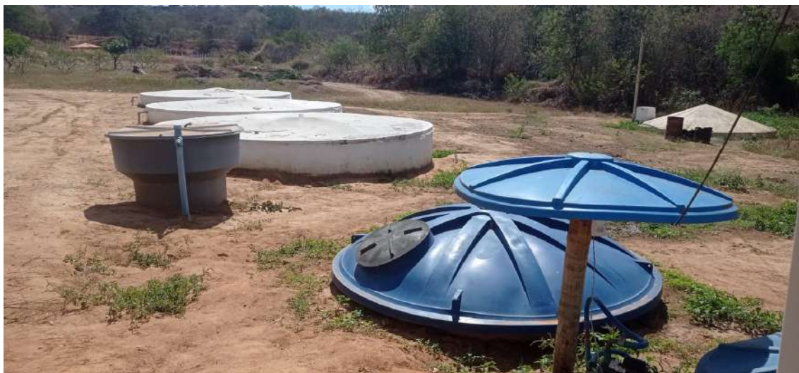
Figura 6 – Infraestrutura do sistema de reuso das águas residuais da EFA de Caculé, 2024.
