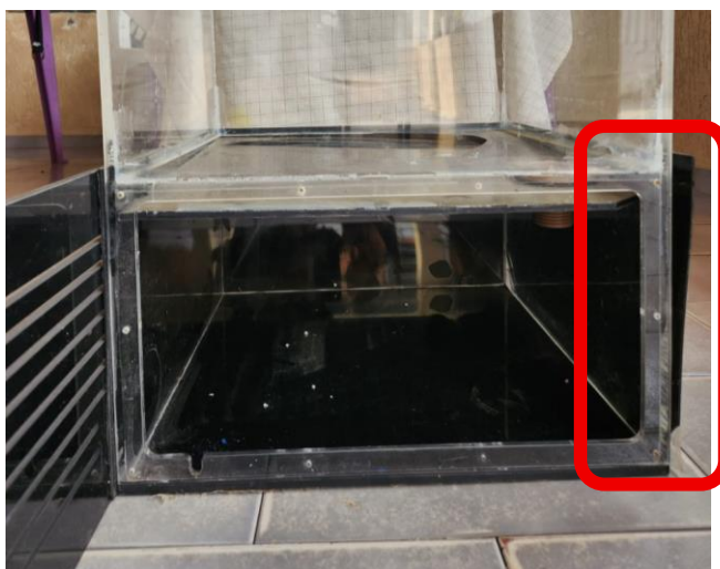
FIGURA 15: Caixa de acrílico com descolamento lateral da estrutura.
