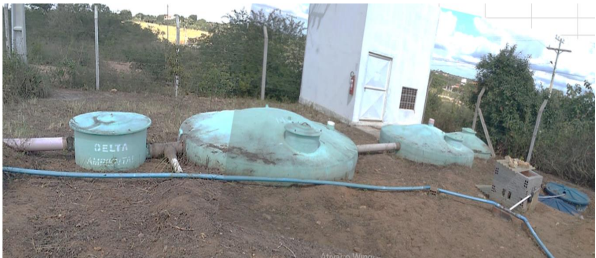
Figura 8. Estação de tratamento de esgoto instalada no campus experimental do Instituto Federal de Educação, Ciência e Tecnologia Baiano, campus Serrinha/BA. FONTE: Autor em 23.08.2021.
