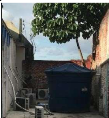
Imagem 18. Sistema de captação de água pluvial do CEHMA – reservatório 1.
