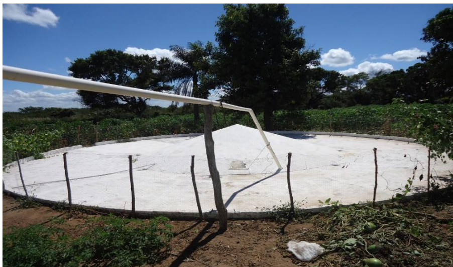
Figura 10. Cisterna chapéu do padre Cícero
