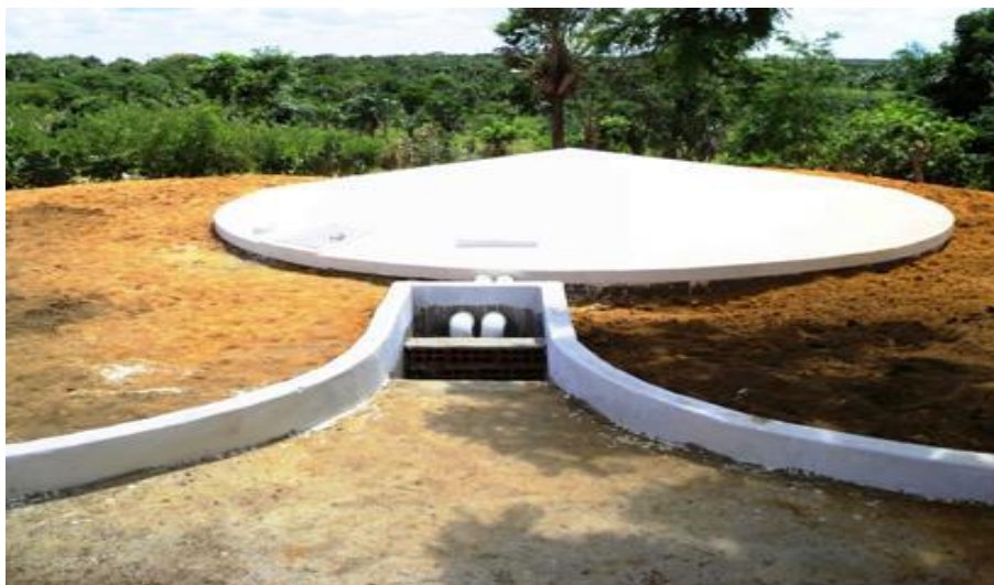
Figura 5. Cisterna de enxurrada
